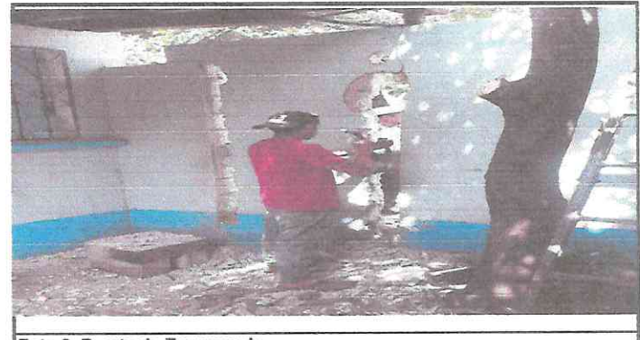
Foto 6: Puerta de Emergencia
